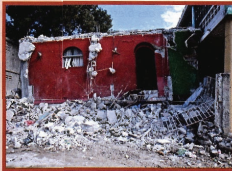
Les ruines de ma maison, à Port-au-Prince
